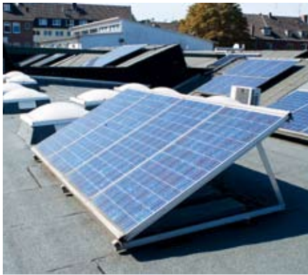
Photovoltaikanlagen auf den Textil-Werkstätten in MG.
